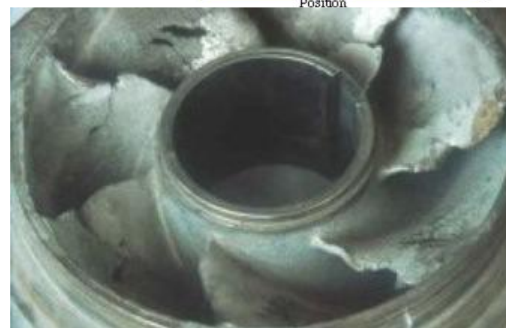
Effets de la cavitation dans une pompe
